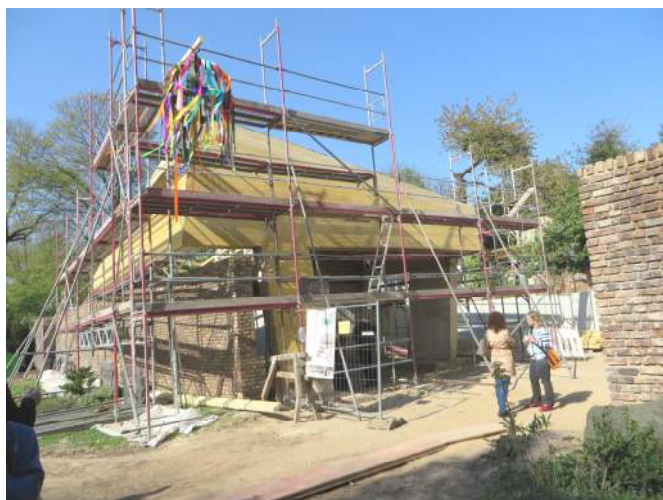
Richtkrone auf Columbarium und Trauerhalle auf dem Evangelischen Friedhof an der Kölnstraße (Foto: Archiv)
